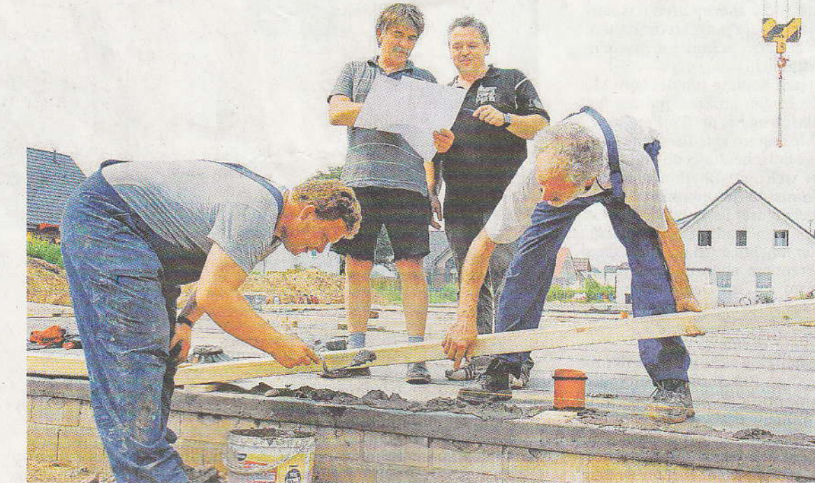
Andrej Stec (li.) und Ewald Schmitz mit zwei Mitarbeitern an der Bodenplatte. Fenster und Türen für die Fertighäuser an der Weller Straße werden bereits in Polen in die Wände eingesetzt.
